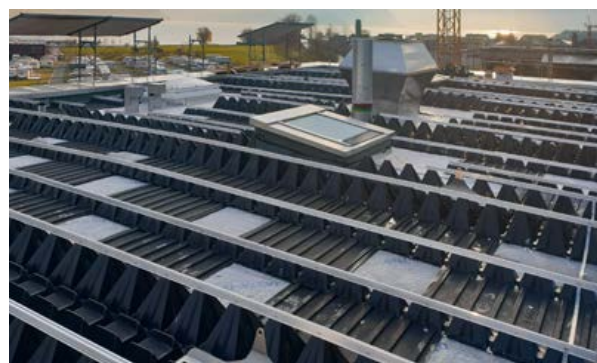
Solaranlage in Buochs
